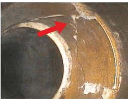
Riss im Anschluss
